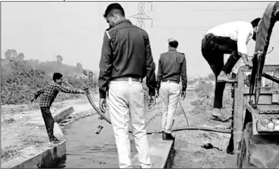
बीसलपुर बांध परियोजना की नहरों से नियम विरुद्ध सिंचाई होने पर परियोजना के अधिकारियों ने नहर पर लगे अवैध इंजन और साइफोनों को हटाया।
