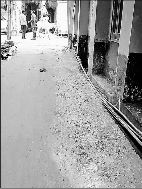
लाखों रूपए की लागत से 15 दिन पहले बने सीसी रोड की गिट्टियां उखड़ना शुरू हो गई हैं।
