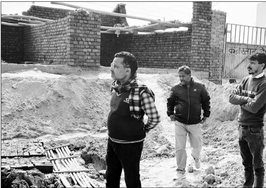
शहर के अजमेर रोड पर मुख्य सड़क किनारे करोड़ों की भूमि पर हो रहा अवैध निर्माण।
