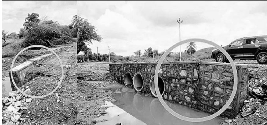
खैरवाड़ा-झूंगरपुर मार्ग पर बारों का शेर के निकट क्षतिग्रस्त निर्माणाधीन पुल की दीवारें।
