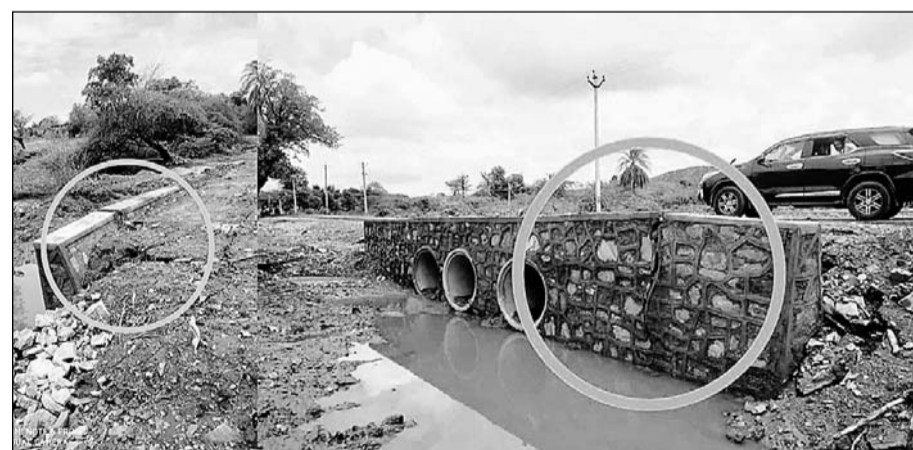
खैरवाड़ा-झुंझुनू मार्ग पर बारो का शेर के निकट क्षतिग्रस्त निर्माणाधीन पुल की दीवारें।
