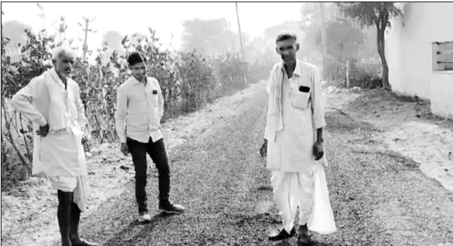
रामगढ़ पंचवारा उपखंड के शाहजहानपुरा में बनाई जा रही सड़क के निर्माण में ग्रामीणों ने घटिया निर्माण का आरोप लगाया।
