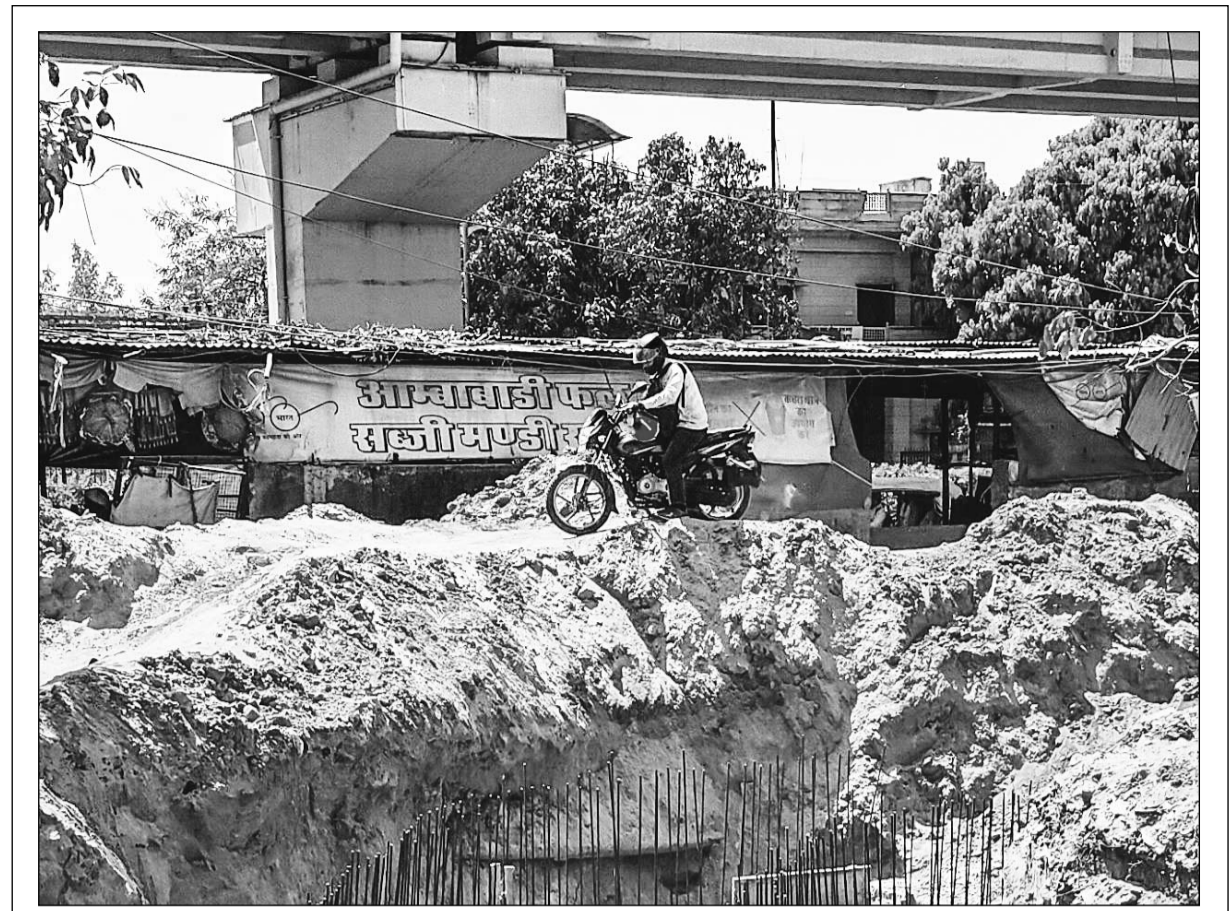
सीकर रोड पर डेहर के बालाजी पर बारिश के दौरान पानी भरवा से निजात के लिए नाला डाला जा रहा है। अंबाबाड़ी सज्जी मंडी के पीछे तक ये नाला पहुंचे काफी समय हो चुका है। तब से इस रोड को खोद कर छोड़ रखा है। लोग लंबा चक्कर बचाने के लिए जीवन जोखिम में डाल कर नाला क्रॉस कर रहे हैं।
