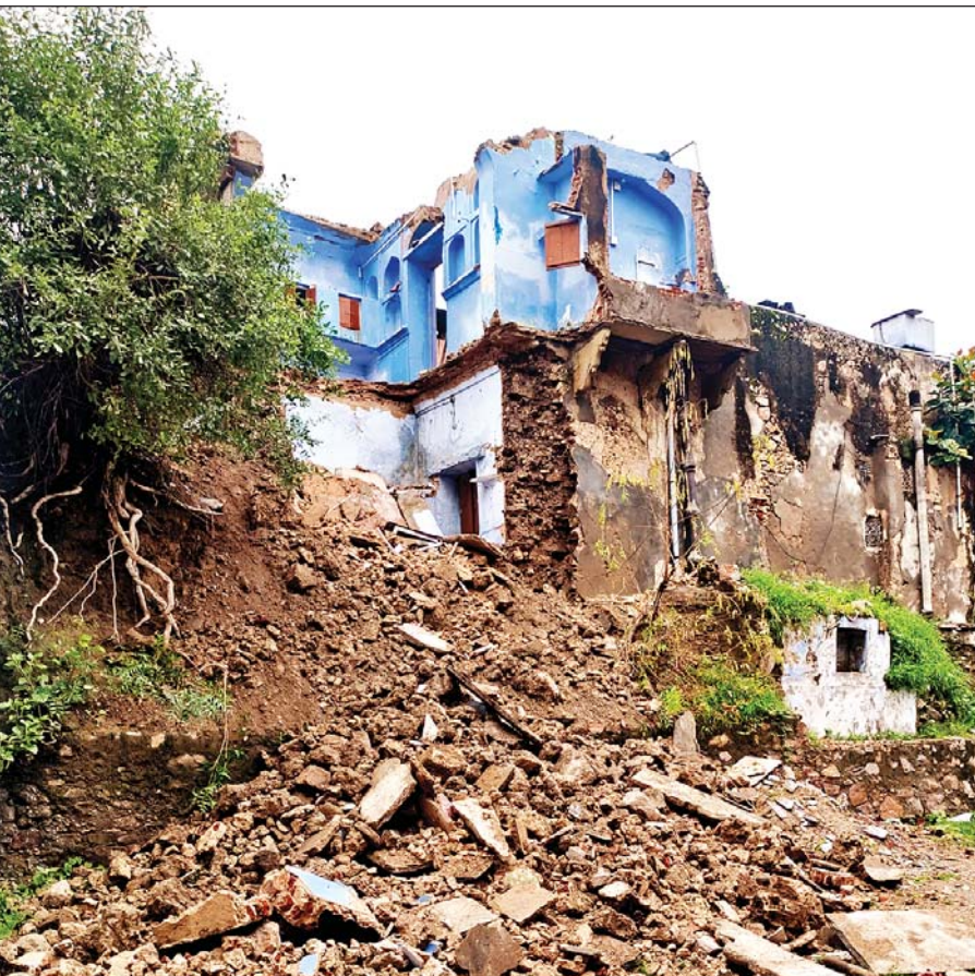
सांभर के वाई नंबर 22 में जर्जर हवेलियां किसी अनहोनी घटना को कारित कर सकती है।
