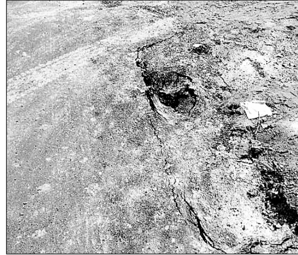
जालोर में बाला कॉलोनी में ठेकेदार द्वारा घंटिया निर्माण सामग्री का उपयोग कर बनाई गई डामर सड़क दो दिन में उखड़ गई।
