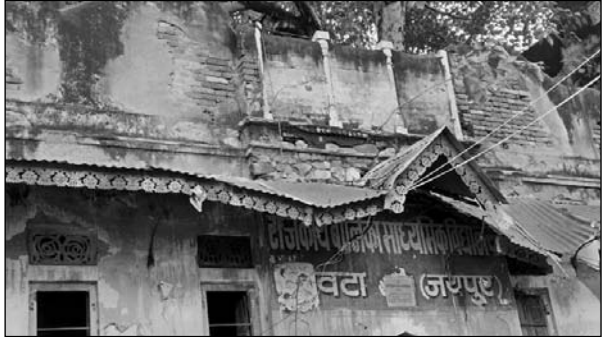
पावटा में पुराना विद्यालय भवन जर्जर अवस्था में पहुंचा।
