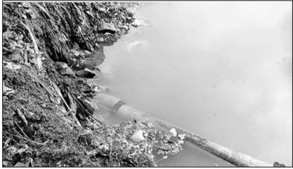
प्रमुख लाइन के क्षतिग्रस्त होने से पानी की समस्या हो गई।
