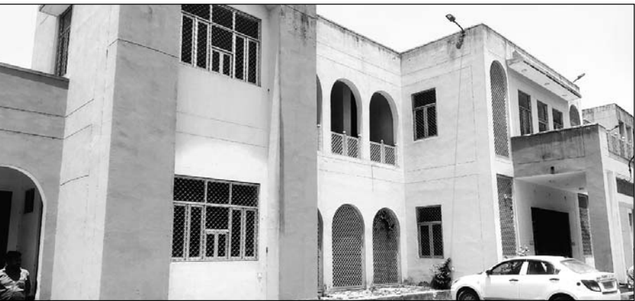
किशनगढ़ बास के बंबोरा में 5 साल से सरकार और अधिकारियों की अनदेखी के चलते उपेक्षित भवन।
