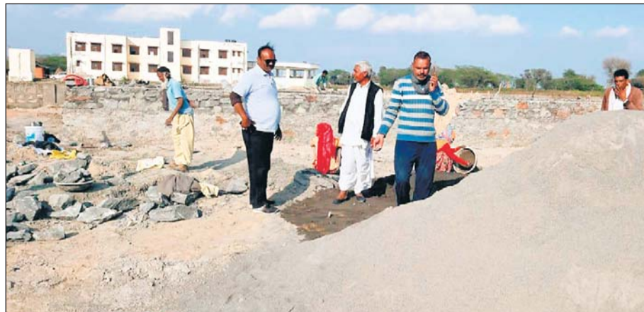
डिगगी उपसंरंपच विजय नारायण शर्मा सहित अन्य ग्रामीणों ने घटिया निर्माण सामग्री का विरोध जताकर नए बन रहे पंचायत भवन का निर्माण कार्य रूकवाया।
