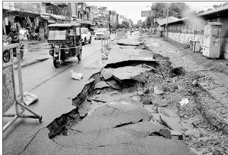
मुरलीपुरा इलाके में दादी का फाटक के पास बुधवार-गुरुवार की मध्यरात्रि तेज बारिश के कारण मुख्य सड़क धंस गई। मिट्टी कटाव के कारण डामर रोड भरभराकर जमीन में बैठ गई। गनीमत रही कि उस वकत कोई भारी वाहन यहाँ से नहीं गुजर रहा था, अन्यथा बड़ा हादसा हो सकता था।
