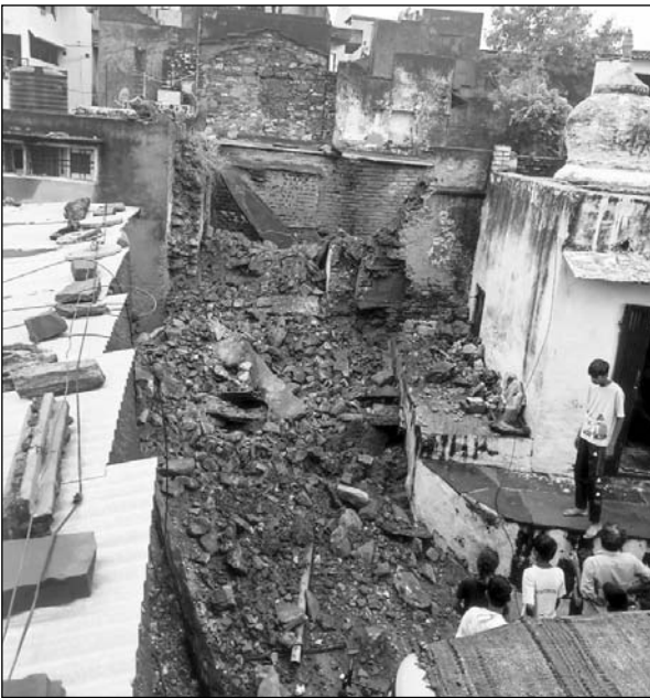
मांडल के मीणा मोहल्ला, गणगौर घाट के समीप मकान ढह गया।
