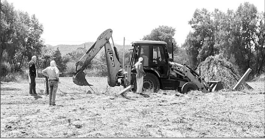
खेतड़ी उपखंड के राजोता ग्राम पंचायत के राजस्व गांव चिरानी की बगड़ियों की ढाणी में गैर मुमकिन नदी में प्रशासन ने अतिक्रमण हटाया गया।
