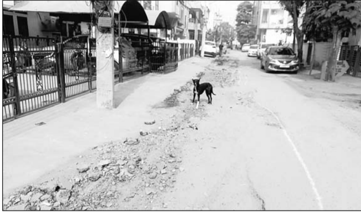
चित्रकूट इलाके में पेयजल लाइन के लिए खोदी गई सड़क की मरम्मत नहीं होने के कारण पूरे इलाके में आये दिन हादसे हो रहे हैं। टूटी सड़क से निकली मिट्टी के कारण दिनभर धूल का गुब्बारा क्षेत्र में छाया रहता है।
