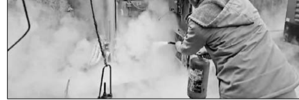
पैनल में लगी आग को बुझाया।
