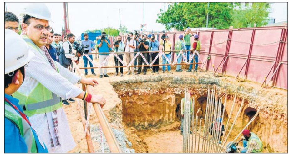
मुख्यमंत्री भजनलाल शर्मा ने शनिवार को हीरापुरा बस टर्मिनल (अजमेर रोड) पर व्यवस्थाओं का जायजा लिया। मु.मंत्री ने, मानसरोवर से अजमेर रोड तक मैट्रो विस्तार के निर्माण कार्य का भी अवलोकन कर अधिकारियों को आवश्यक निर्देश दिये।
