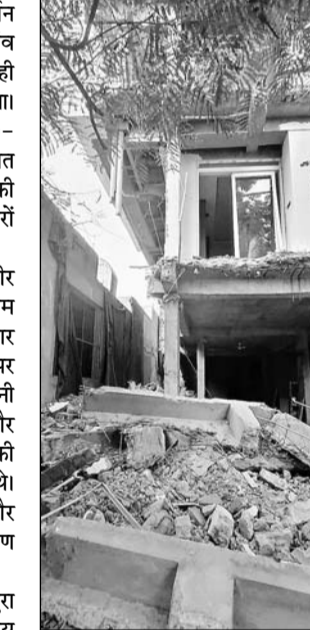
चार मंजिला भवन बना लिया गया था। अवैध हिस्से में बने कमरे, बालकनी और लेटबाथ को ध्वस्त किया।
