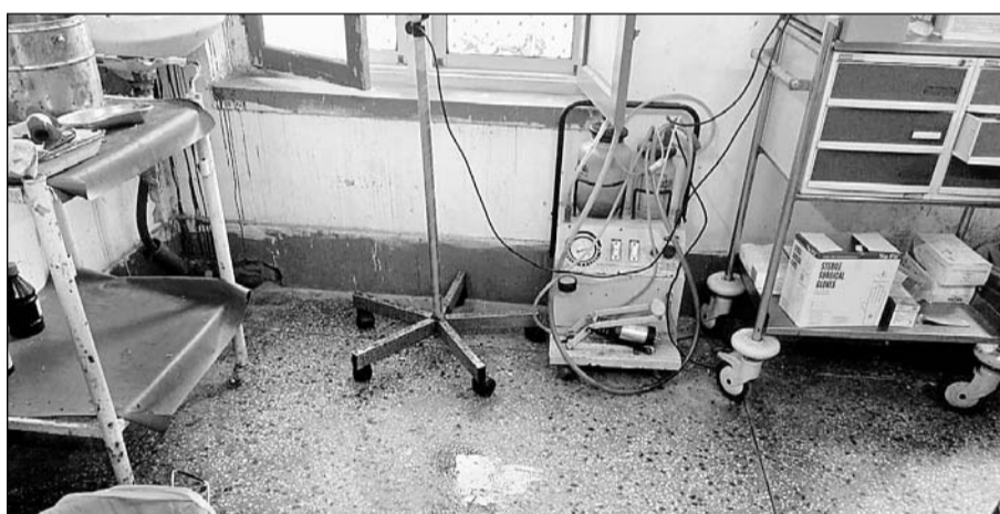
पावटा सीएचसी के इमरजेंसी वार्ड में पानी टपकने से उपकरण खराब हो रहे हैं।
