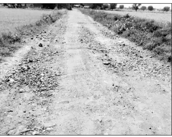
अलवर ग्रामीण विधानसभा क्षेत्र में दादर जयंती फैक्टरी के पास से पलखड़ी जाने वाली सड़क कई जगह से उखड़ गई है।
