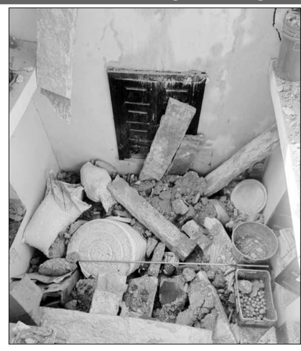
पाली में इंदिरा रसोई के स्टोर रूम की छत ढह गई।
