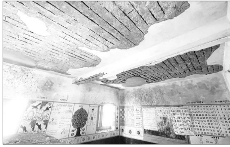
छत में लगे लोहे के सरिमे बाहर नजर आने लगे हैं।
