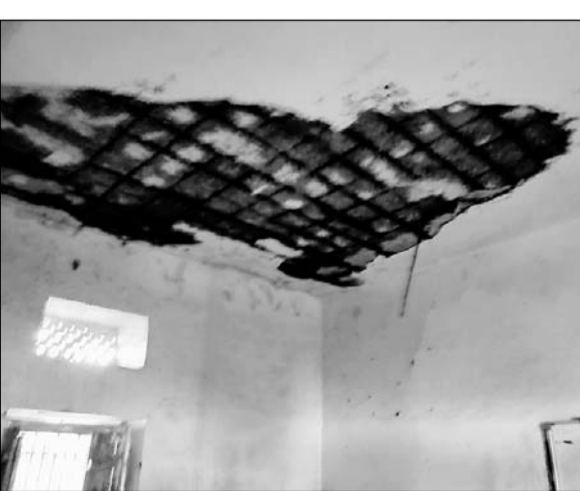
बरोडिया गांव के सीनियर स्कूल की जर्जर छत।
