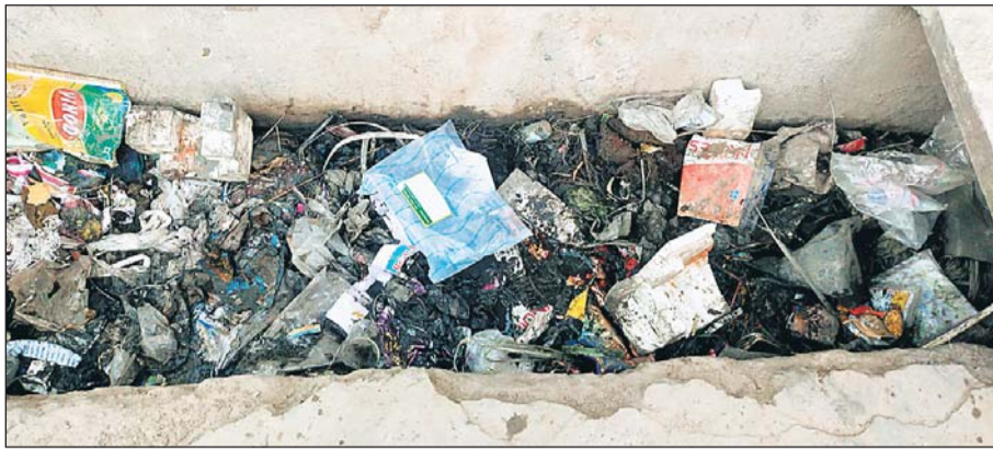
गंदगी से भरे मालपुरा शहर के नाले।
