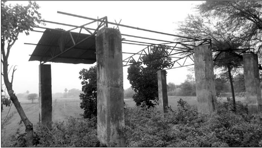
ग्राम पंचायत आंमा का शमशान घाट अपनी बदहाली पर आंसू बहा रहा है।
