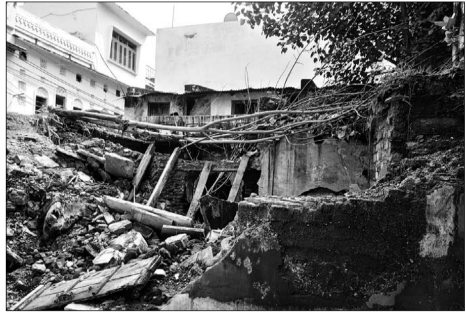
देवली शहर के बीचों-बीच जर्जर अवस्था में खड़े भवन हादसे को न्योता दे रहे हैं।
