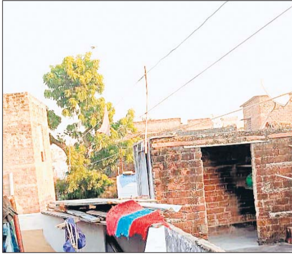
वार्ड 9 में मकानों को छूकर बिजली की लाइनें गुजर रही हैं।
