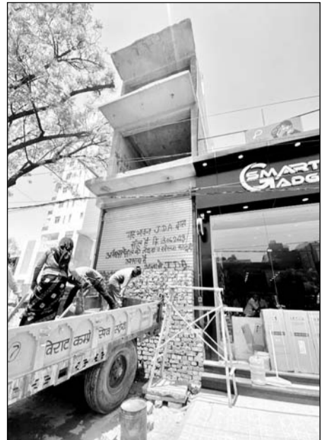
जेडीए की प्रवर्तन टीम ने मालपुरा गेट इलाके में बनी अवैध दुकान के शहर के आगे ईंटों की दीवार बना सीलिंग की कार्यवाही की।
