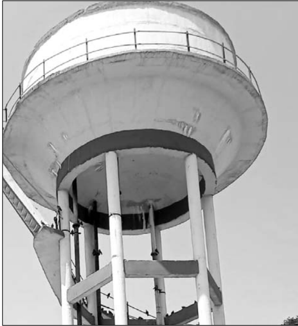
टिगरिया गांव में पेयजल सप्लाई के लिये बनी टंकी।
