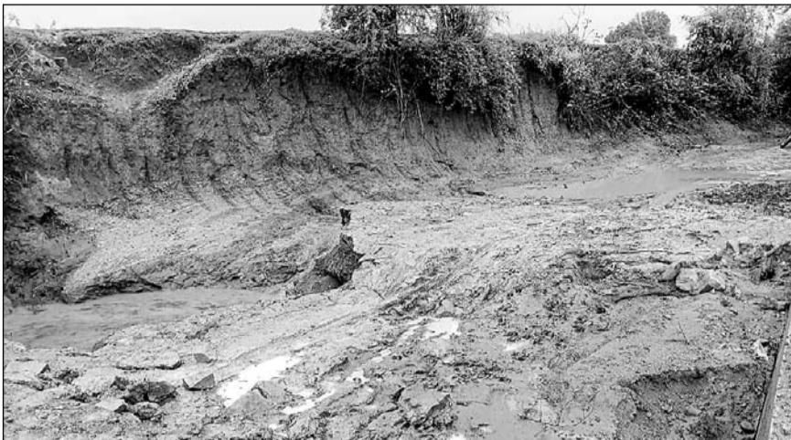
पुलिया के दोनों ओर सी.सी. की जगह मिट्टी डालकर खानापूर्ति की गई।
