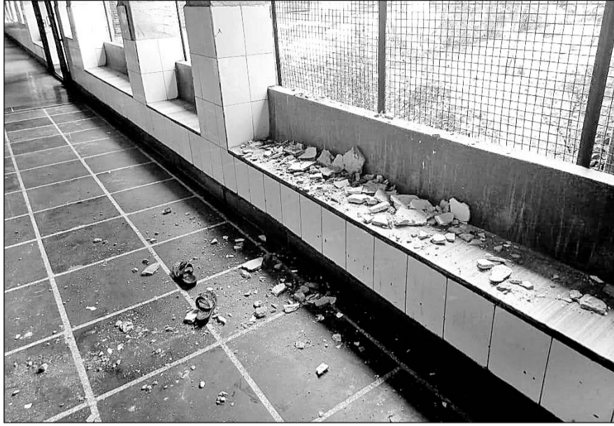
भीण्डर हॉस्पिटल में छत से टपकता हुआ पानी और क्षतिग्रस्त छत।
