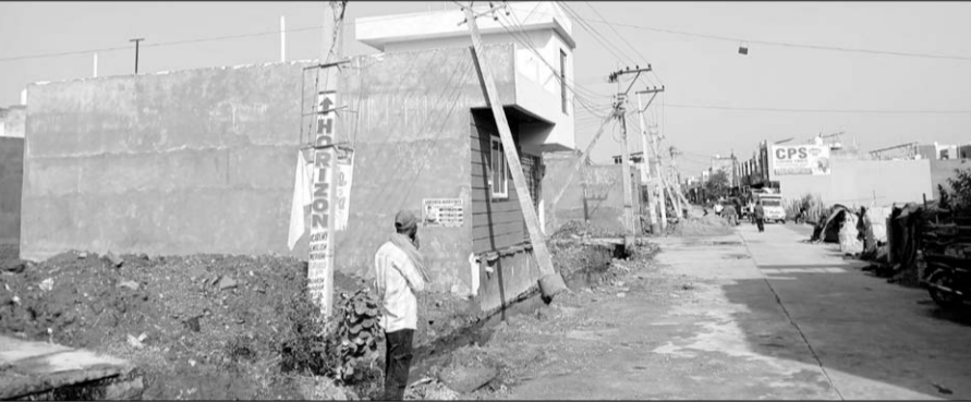
कोटा के थेकड़ा इलाके में नाला निर्माण के दौरान की गई खुदाई के चलते विद्युत पोल गिर गए।
